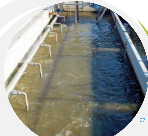
Vasca di pretrattamento di sabbatura e di soleatura.
